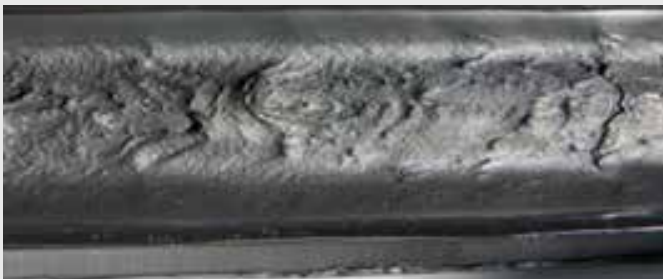
ejemplo de mala ejecución
