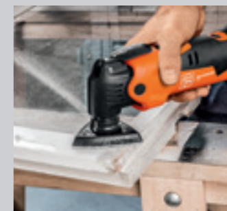
Renovación de ventanas completa: en cualquier lugar, también con independencia de la red.
