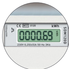
Panel equipado con un medidor de consumo energético conforme a la MID
