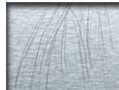
Arañazos profundos en la superficie.
